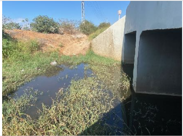
נחל אביחיל ביציאתו ממעביר המים מתחת לכביש 4. תעלות בטון מעבירות מים המנוקבים מהכביש. אזור המעביר נמוך ומוצף במים משני צדדיו. צמחיה: פספלום דו טורי, דוחן זוחל ויבלית מצויה. חיל החולות התבסס בצידי הכביש.
