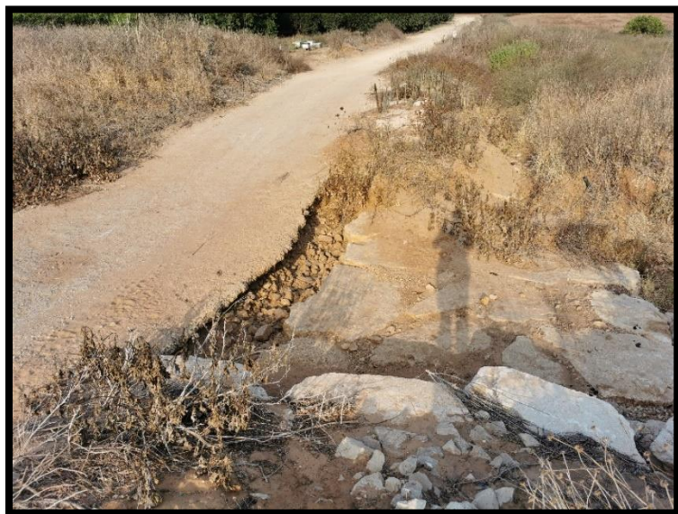
תמונה 3 ב' - מתקן מספר 12, גשר אירי תקול
